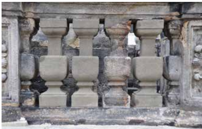
Obr. 4. Plzeň, morový sloup, detailní pohled na stav balustrády a jednotlivých kuželek po prvotním očištění, patrné původní kamenné kuželky i výdusky, zdroj: Národní památkový ústav, územní odborné pracoviště v Plzni, foto: autor, 2021
