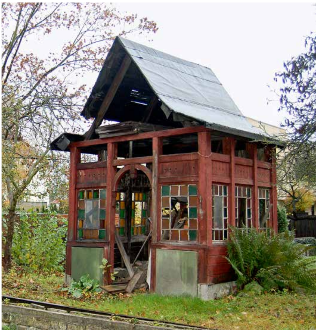
Obr. 2. Plzeň-Bezovka, altán v zahradě vily čp. 1599 na Klatovské třídě, postavené stavitelem Rudolfem Pelcem, autor altánu neznámý. Uprostřed zahrady se nacházel kruhový bazén s vodním prvkem, dodnes patrný. V současné době z altánku zbyla jen základová deska, zdroj: Národní památkový ústav, územní odborné pracoviště v Plzni, foto: autorka, 2008
