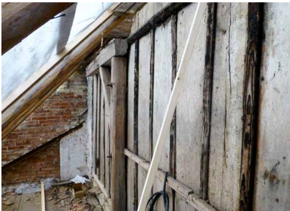
Obr. 17. Vysoká, čp. 1, pohled na prkenné obložení severní roubené stěny; prkna jsou obilena, latě zčernalé, zřejmě stopy po požáru, foto: Zuzana Vařeková, 2013
