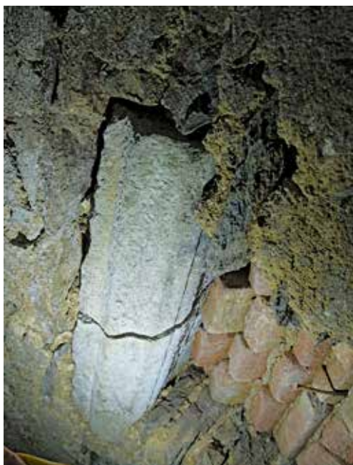
Obr. 9. Fara v Hořepníku, sklepení, kamenný profilovaný překlad nad zazděným okénkem v jihovýchodní zdi, pohled od jihozápadu, foto: autor, 2021
