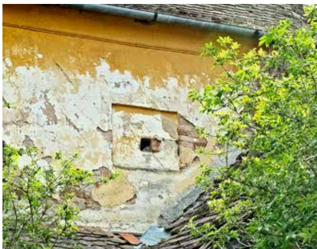
Obr. 12. Fara v Hořepníku, severovýchodní fasáda s prosvítajícím nátěrem dekoru pasparty okna na schodiště do krovu, vedle střechy hospodářské přístavby, pohled od severovýchodu, foto: autor, 2021
