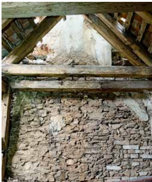
Obr. 13. Fara v Hořepníku, severovýchodní fasáda v úrovni patra, pod střechou hospodářské přístavby, dvě zazděná okénka symetricky umístěná nad negativem po starší střeše a holá zeď fary bez fasádní úpravy, pohled od severovýchodu, foto: autor, 2021
