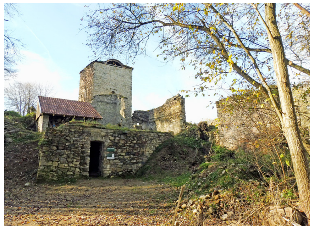
Obr. 8. Pasovary, bývalá tvrz, stav po opravě sklepů gotického paláce (B) a zastřešení jejich části pultovou střechou. Ve sklepech se nachází výstava k historii tvrze, foto: Radek Liška, 2022
