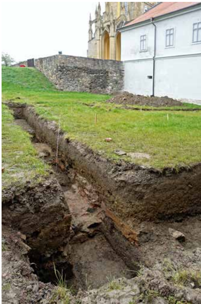
Obr. 1. Kladruby, klášter, sondy severně od nového konventu zachycující mohutné zdivo zaniklé sladovny z 19. století, zdroj: NPÚ, ÚOP v Plzni, foto: Linda Foster, 2022
