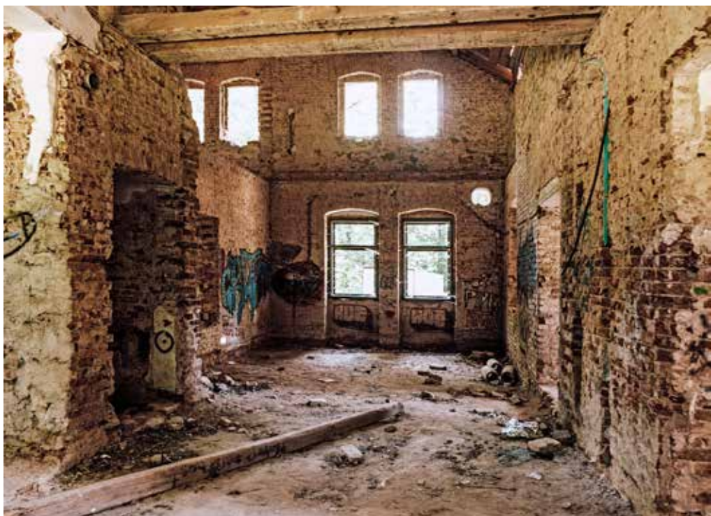
Obr. 5. Jindřichův Hradec, Nežárecká čp. 121, výletní restaurace Rudolfov, devastovaný interiér budoucího výčepu, foto: Miloš Bučinský, 2020
