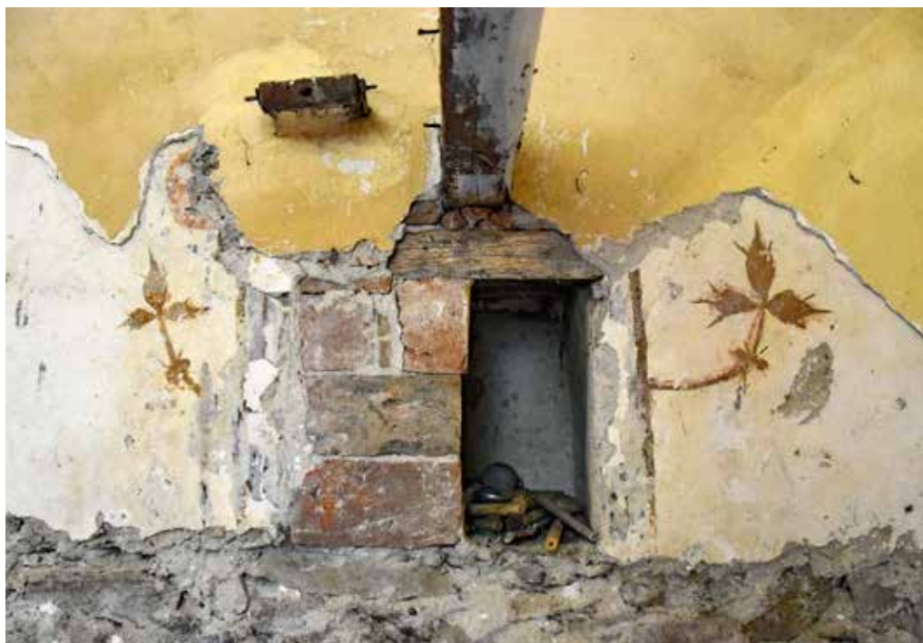
Obr. 1. Čejetice, kostel sv. Havla, fragmenty malířské výzdoby okolo bývalého sanktuáře před restaurováním, foto: Jan Eliška, srpen 2023
